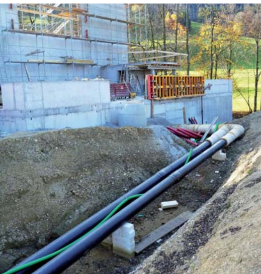
Fernwärmenetz in Bühler.
