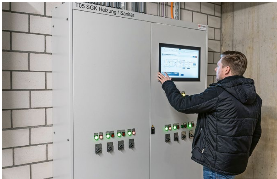
Plausibilisierung von Daten im Gebäudeleitsystem.
